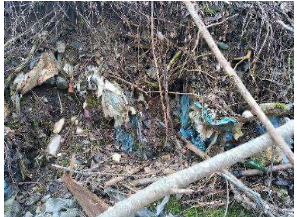
Erosion de berge au droit de l'ancienne décharge
