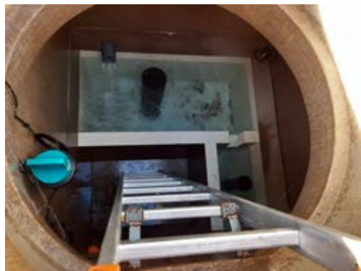
Captage du Parc - Saint-Paul-sur-Isère © Arlysère
