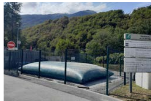
Citerne de protections incendie à la déchèterie de La Bâthie © Arlysère
